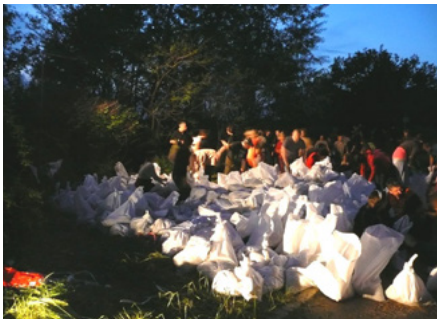
Fot. 8. Nocna akcja ratowania przeciekającego odcinka Grobli Siechnicko-Księskiej w rejonie ul. Starodworskiej. Księże Wielkie, 22 maja 2010 (Fot. A. Czmuchowski)
